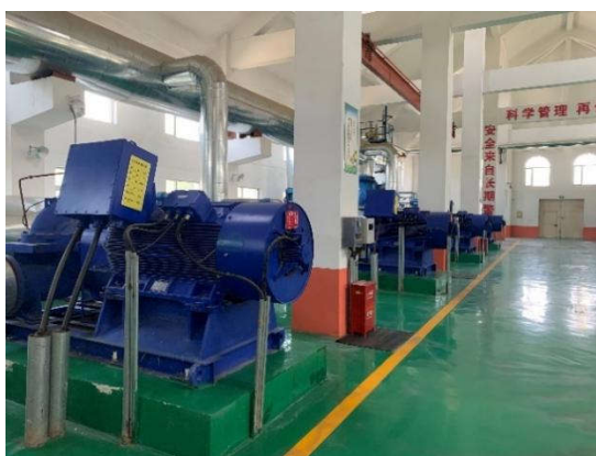
图 4.3-1 中继泵站供水加压泵组
