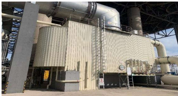
图 4.2-1 #1 机组高背压凝气器
