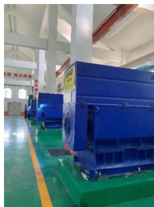
图 4.3-2 中继泵站回水加压泵组
