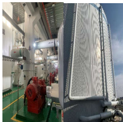
图 4.2-4 调峰电锅炉机组及储能罐
